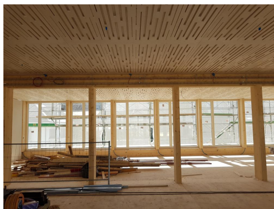
En plafond, un système d'absorption phonique a été directement intégré.
